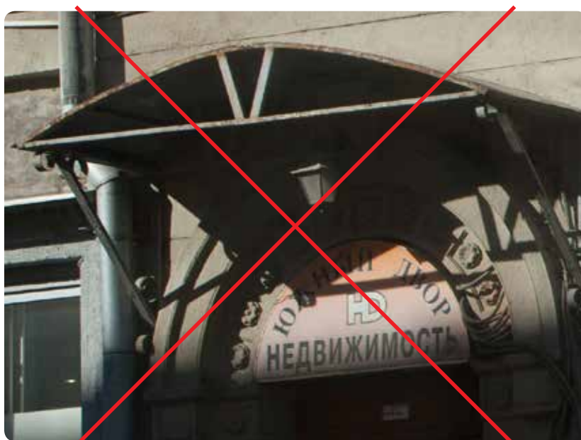
Козырек закрывает детали фасада и не соответствует архитектуре
