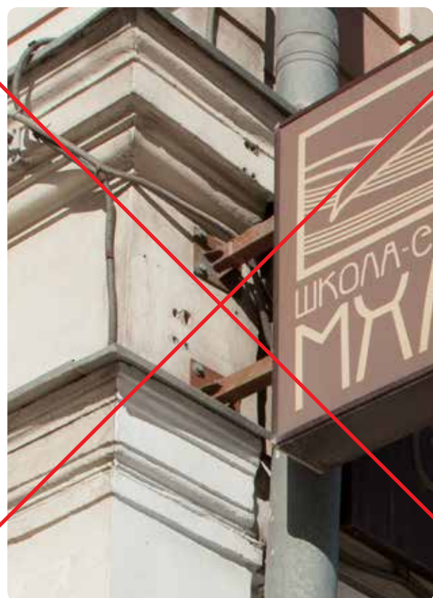
Покрытое ржавчиной крепление с бросающимися в глаза элементами крепежа, установленное на неподготовленном участке фасада (видны отверстия от креплений предыдущей вывески)
