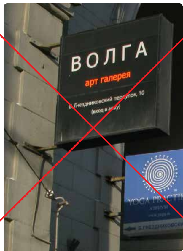
Небрежно выполненные крепления, покрытые ржавчиной
